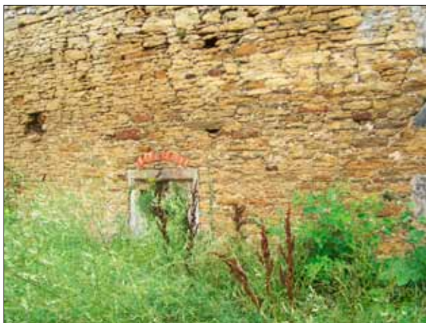
Fot. 3. Zamek w Ćmielowie. Widoczne braki spoiny i zniszczenia powierzchni piaskowca. (fot. B. Klimek, 2011).
