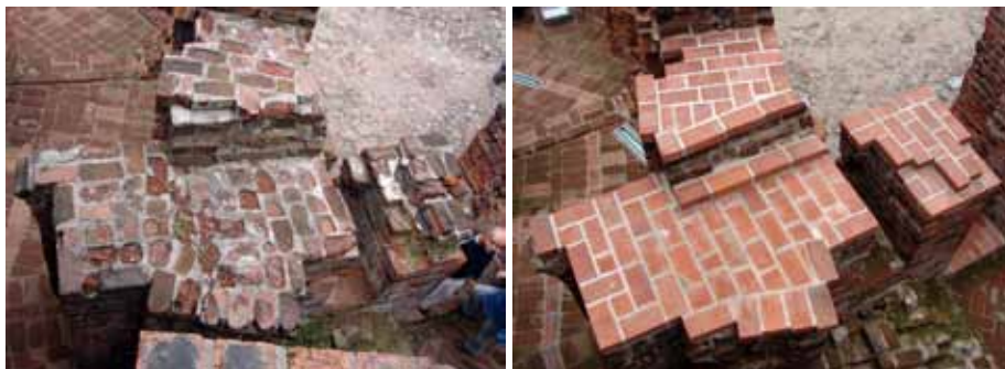
Fot. 5. Nakrywy ścian wewnętrznych, skrzydło północne: A – przed konserwacją, B – stan po konserwacji, fot. L. Narębski.
