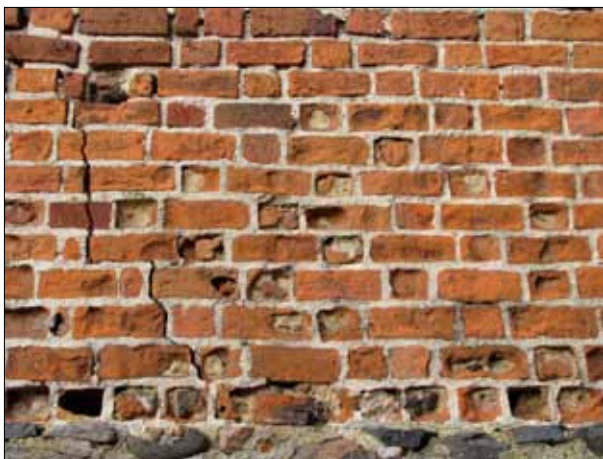
Fot. 1. Zamek w Liwie. Największe zniszczenia muru historycznego - ubytki oryginalnych cegieł, występują w strefie połączenia muru kamiennego z ceglany. Zniszczenia te intensyfikuje wcześniejsze użycie do spoinowania zaprawy cementowej (fot. B. Klimek, 2011).
