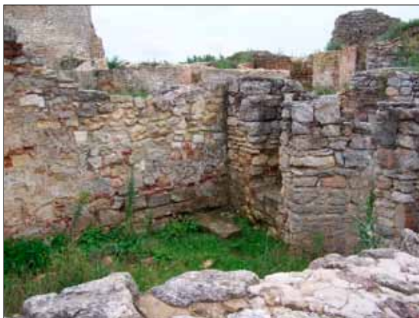
Fot. 2. Zamek w Iłży. Zastosowanie zapraw cementowych do wmurowywania i spoinowania nie przyniosło zadowalających rezultatów. Spoiny ze względu na właściwości zaprawy cementowej, odspoili się, popękały, co spowodowało, że woda z opadów atmosferycznych przenika do wnętrza murów powodując ich zawilgocenia (fot. B. Klimek, 2011).
