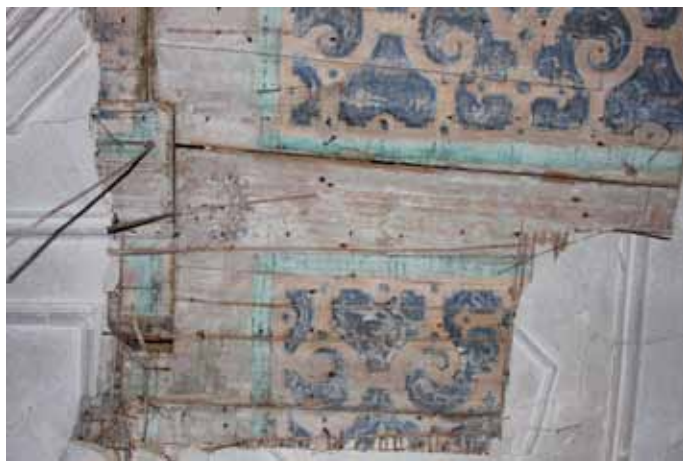
Fot. 4. Fragment stropu polichromowanego widoczny spod późniejszych sztukaterii.
