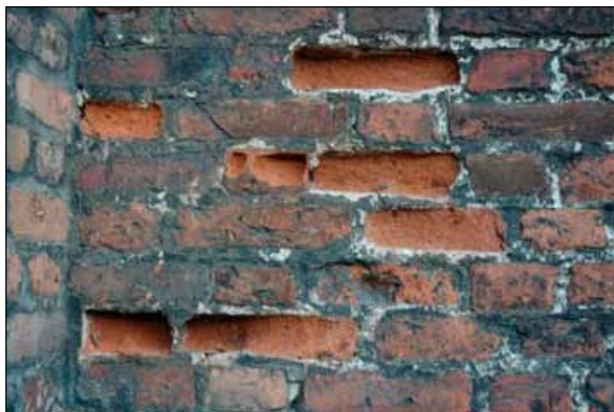
Fot. 2. Liczne głębokie ubytki w ceglach, będące wynikiem pudrowania się i osypywania się materiału o bardzo niskiej wytrzymałości mechanicznej, przyczyny tego zjawiska poszukiwano w rozwoju bakterii nityfikacyjnych.
