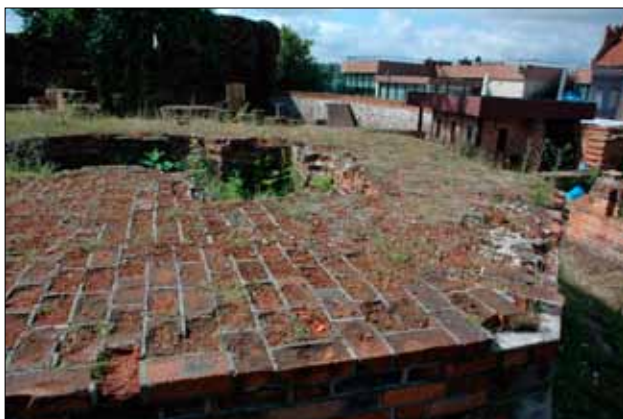
Fot. 1. Czynniki zewnętrzne i wewnętrzne przyczyniające się do zniszczenia ruin zamku krzyżackiego w Toniniu, korozja biologiczna wywołana wzrostem drobnoustrojów i wyższej roślinności zielnej, spękania, ubytki powstałe w wyniku zastosowania materiałów o nieodpowiednich właściwościach zarówno cegieł jak i zapraw cementowych, w oddali mur pokryty wykwitami soli łatwo i trudno rozpuszczalnych.
